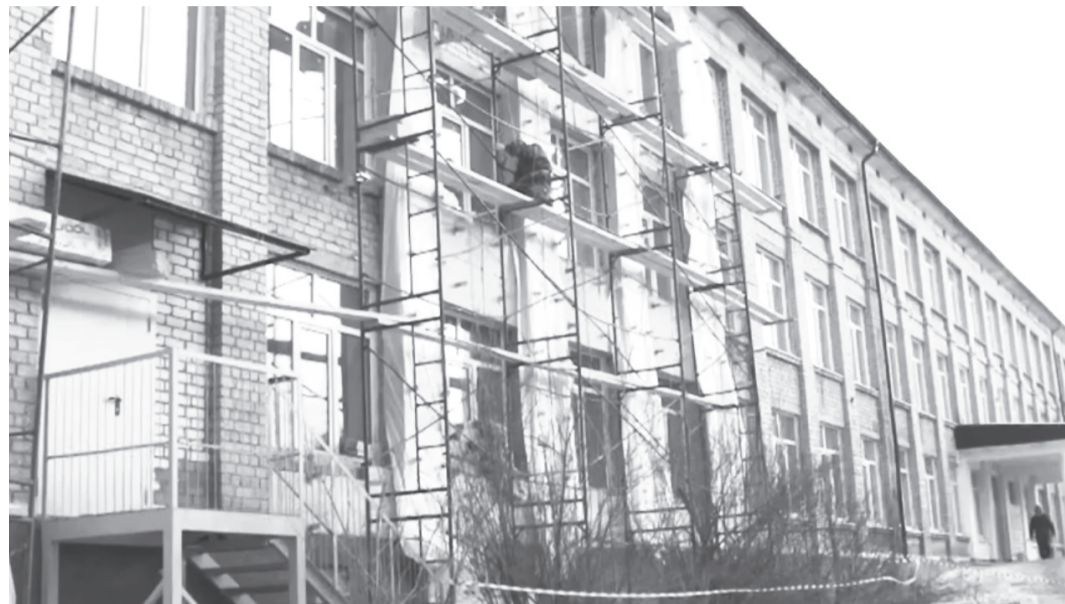
Закрытая в 2016 году школа № 10 уже в феврале начнет набор первоклассников. Реконструкция объекта взята на контроль областным правительством. В 2020 году в региональном бюджете заложены все необходимые средства для завершения капремонта - более 104 миллионов рублей.
